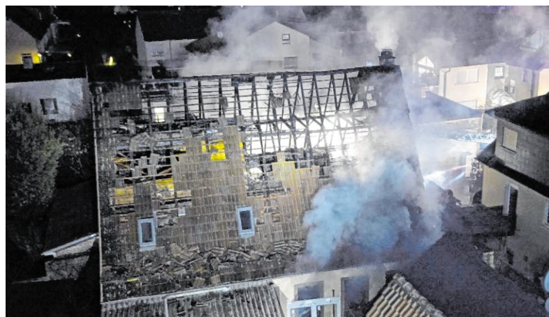
Von der Drehleiter aus betrachtet, wird das ganze Ausmaß des Schadens nach dem Brand in Edingen deutlich.
